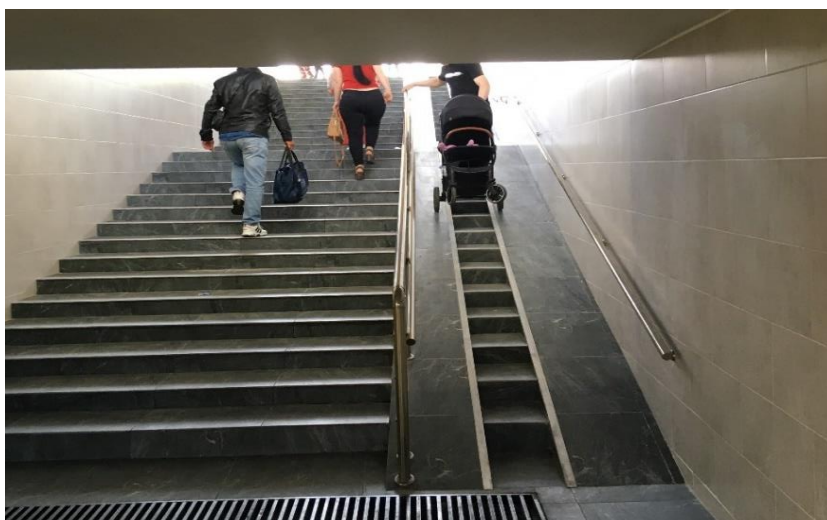
Imaginea 3. „Rampa” construită este periculoasă Sursa: foto CDPD
